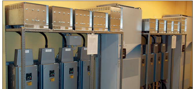
Cressall DBR Series bromsmotstånd installerade ovanför frekvensomformarna på ett pappersbruk.
